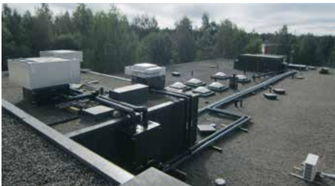
Ilmanottokatoksia ja LTO-huippumureita Kokkolan terveyskeskuksen katolla.
