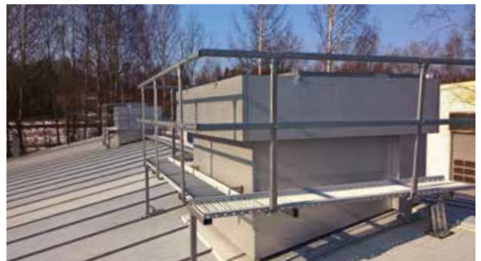
Ilmanottokatos (ilmavirta 1 m 3 /s) huoltotasoilla varustettuna.
