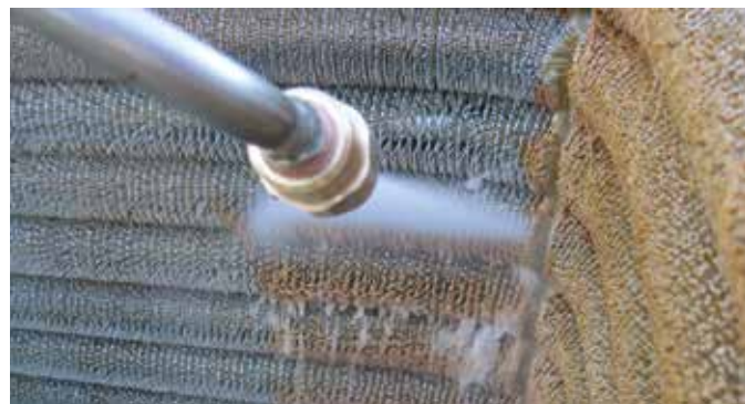
Lähikuva McDonald's'in keittiön LTO-huippuimurin pesusta.
