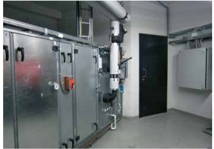
RETCARE MODULAR -tuloilmakone, jonka mitoitusilmavirtaama on 10 000 l/s. Tämän koneen LTO-neulalämmönsiirtimien huolto tapahtuu suodatinosan ja raitisilmakammion kautta.
