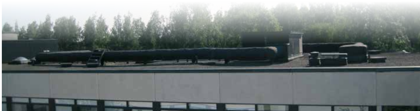
Tilanne ennen muutosta. A-siiven LTO-konehuone, jossa vaaka-asenteinen pyörivä LTO-kiekkokone ja apupuhaltimet. Tuloilma oli kanavoitu vesikatolla LTO-konehuoneesta tuloilmakoneiden ilmanottoon.
