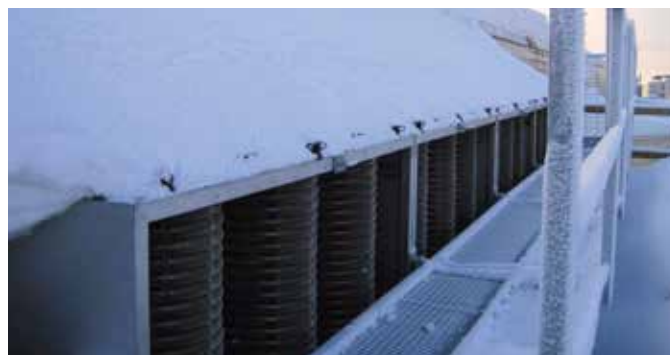
Retermia ulkosäleikköpatterit helmikuussa 2011. Viiden vuodeosaston tuloilman lämmöntalteenotto, tuloilman esisuodatus ja lumentorjunta. Kokonaisilmamäärä 22m 3 /s, jolloin neulalämmönsiirtimien ilmapuolen painehäviö 50 Pa.
