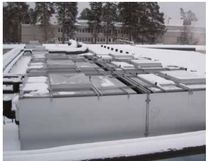
Keittiön poistoilmasta lämpöä talteenottavia LTO-huippuimureita.
