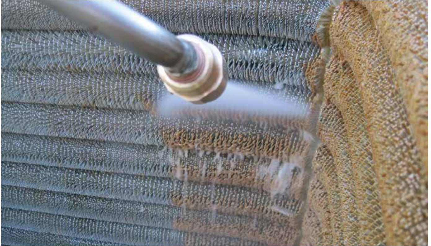
Mc Donald's rasvahuuvan LTO-huippumurin neulapinnan pesua. Kuva on otettu noin 5 kuukauden käytön jälkeen.
