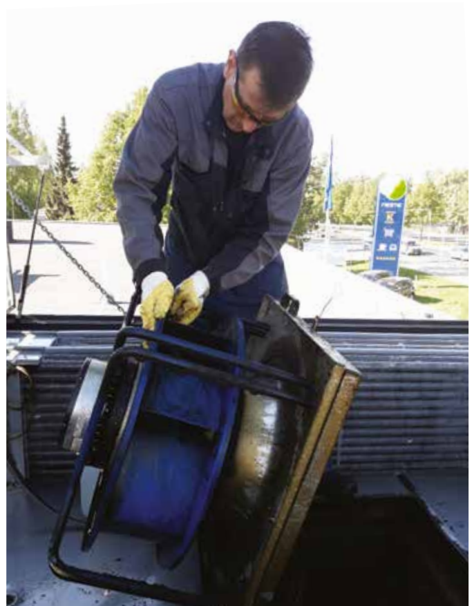
Retermian LTO-laitteet on varustettu huoltokansilla, vesitii- viillä pohjavadilla sekä useilla pesu- ja kondenssivesiviemä- reillä. LTO-huippumurin sisällä on tila huoltohenkilölle ja pohjavati kestää huoltohenkilön painon. Poistoilmakanavisto päästään nuohoamaan LTO-huippumurin kautta kippaamalla poistopuhallin sivuun.
