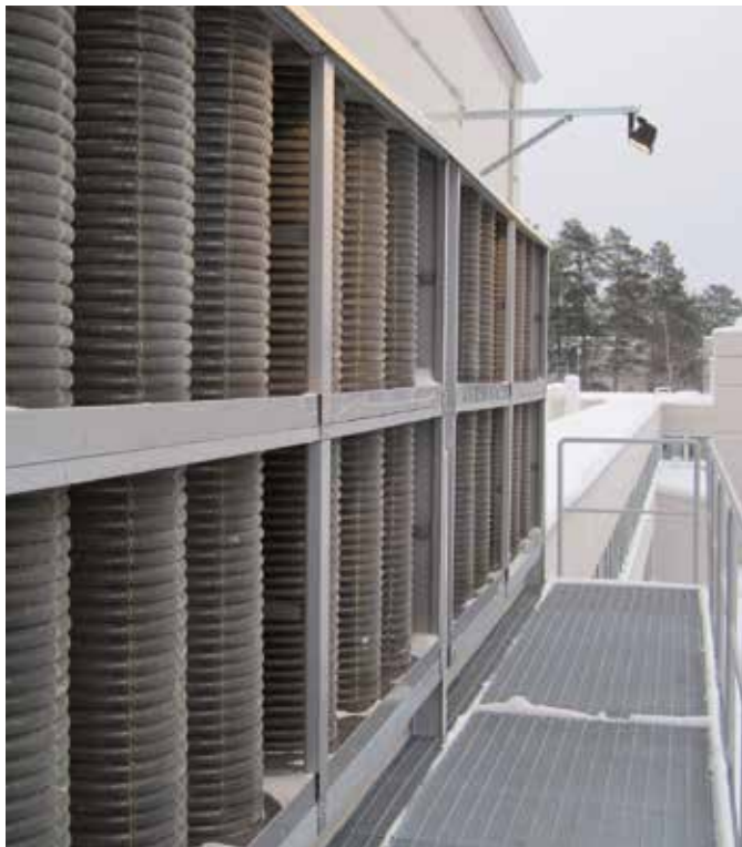
Ravintokeskuksen neulalämmönsiirtimet ulkosäleikön tilalle asennettuna. Neulalämmönsiirrin estää lumen ja kosteuden tunkeutumisen IV-järjestelmään. Tuloilmavirta 26 m 3 /s.
