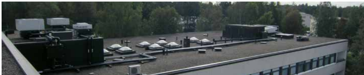
A-siipi muutoksen jälkeen. Vesikatolla olevat kanavoinnit on purettu. Poistoilmasta otetaan lämpöä talteen EC-puhaltimilla varustettujen LTO-huippuimureiden avulla nesteeseen ja lämpö luovutetaan tuloilmaan ilmanvaihtokonehuoneen vesikatolla olevilla kahdella tuloilmakonekohtaisella ilmanottokatkoksella, jotka näkyvät näkyvät kuvan vasemmassa reunassa.
