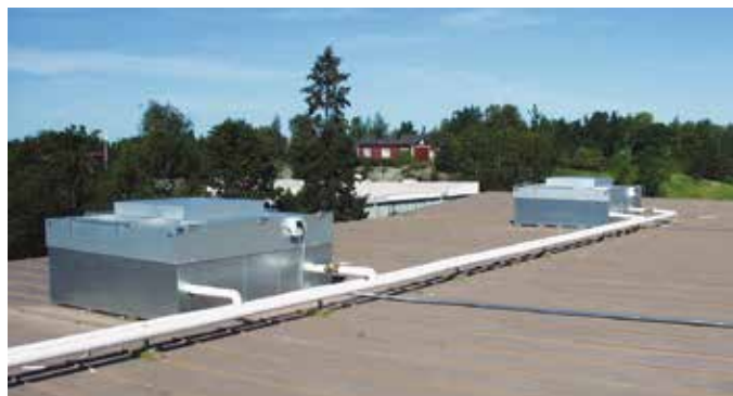
LTO-huippuimureita Vihdin koulun katolla. Hajautettu ilmanvaihto on mahdollista toteuttaa energiatehokkaasti LTO-huippuimureiden avulla.
