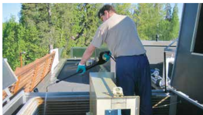
McDonald's'in keittiön LTO-huippuimurin (ilmavirta 2,4 m³/s) huolto. LTO-huippuimuri on ihanteellinen ratkaisu ammatti-keittiöihin.
