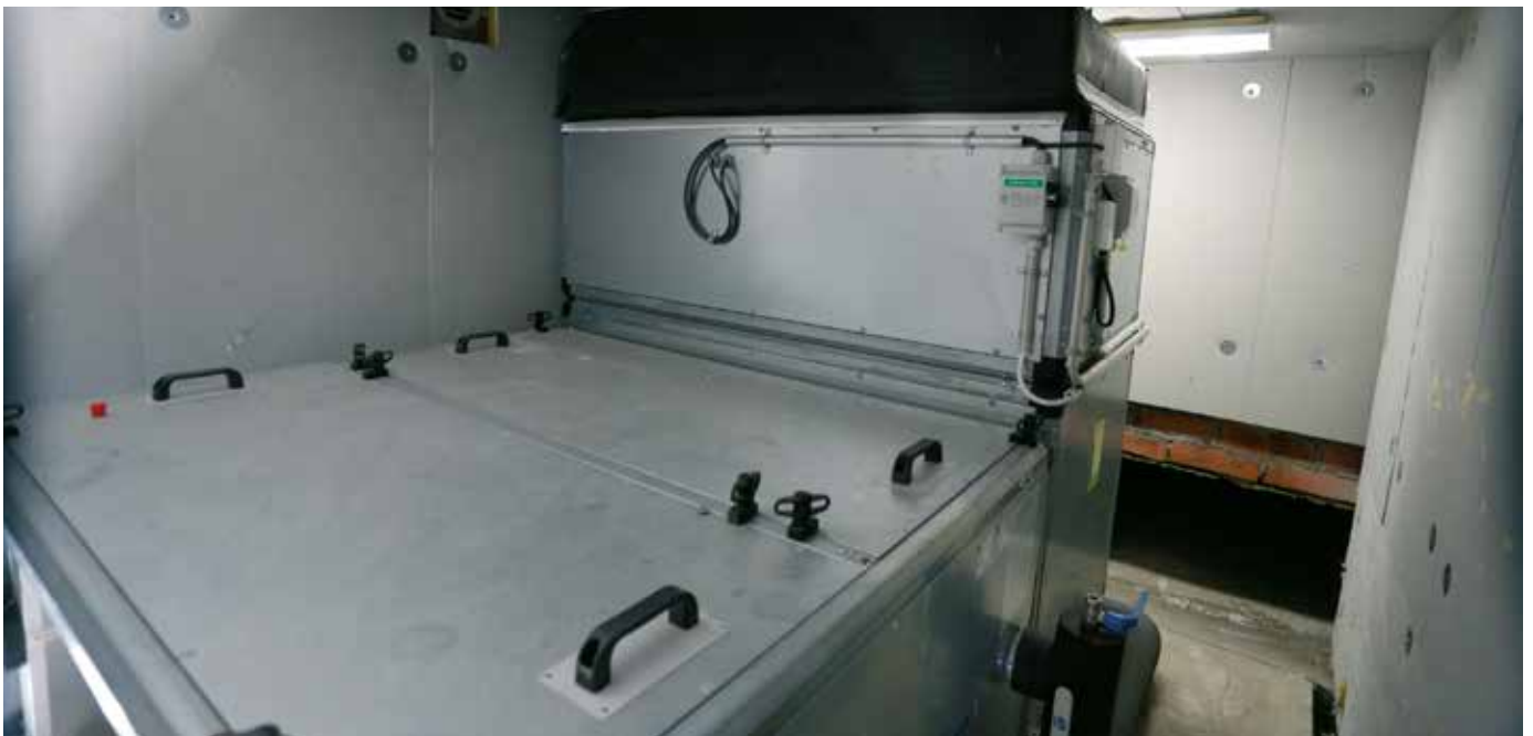
RETCARE IN E -poistoilmakone asennettuna puhallinkammioon.
