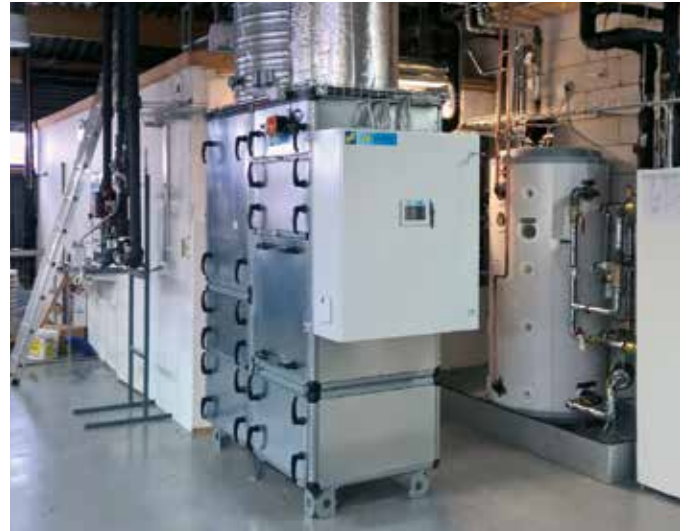
RETCARE IN S -tuloilmakone asennettuna tuotantotilaan. Kuvan tuloilmakoneen SFP on 1000 l/s mitoitusilmavirralla 0,6 kW/m 3 /s sisältäen kanaviston ja koneen ulkopuolisen LTO:n ja jäähdytyspatterin painehäviön. Kone tarvitsee ainoastaan neljän verran lattiapinta-alaa.
